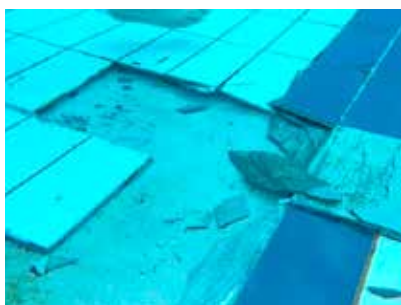
既存タイル剥離部分
